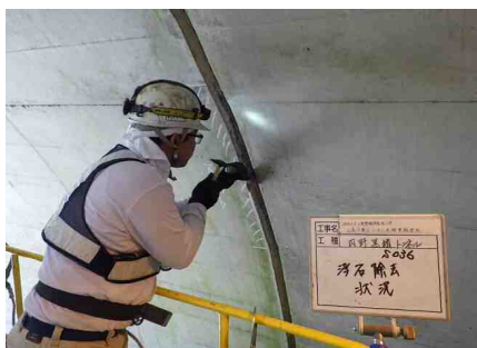
浮きクラック近接目視の際、容易に除去できる箇所はその場で除去 (内野黒猪トンネル)
