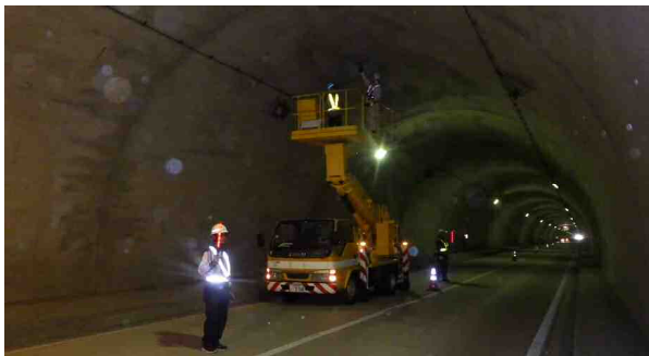
浮きクラック近接目視状況 (首石トンネル)
